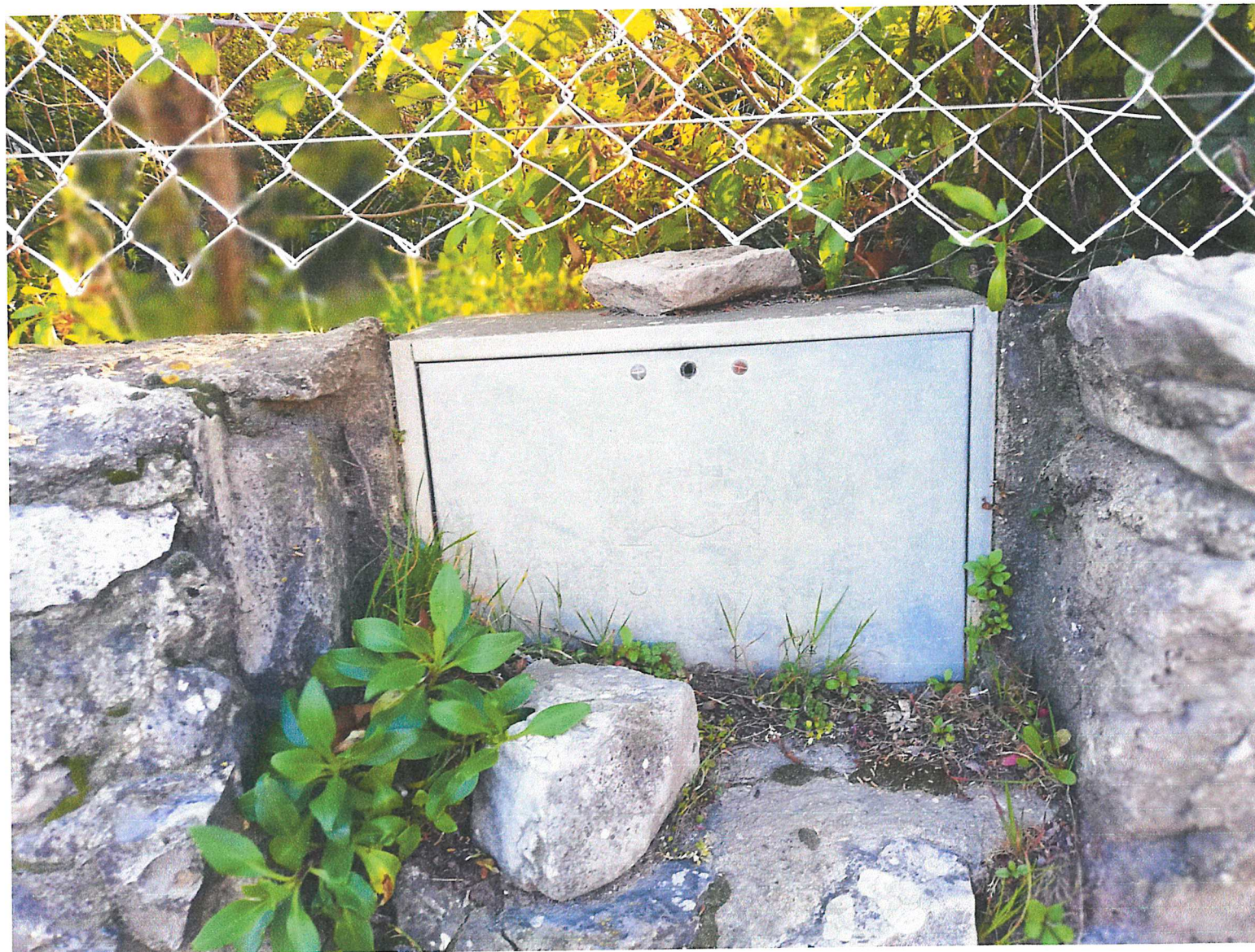
Compteur eau clôture de notre terrain.
